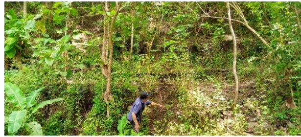
Gambar 2. Kenampakan lereng batuan lava andesit terlapukkan di sekitar lokasi JS-4 dengan arah kemiringan dominan ke barat laut, yang menunjukkan kontrol struktur geologi terhadap orientasi lereng dan perkembangan jaringan diskontinuitas yang berimplikasi pada penurunan kestabilan lereng.
